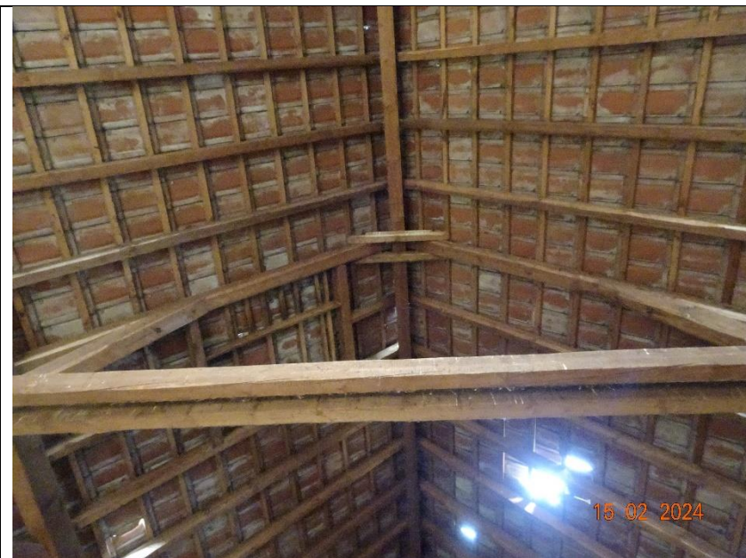
Foto 9: Kotrückstände auf den Querbalken des Dachstuhls belegen ebenfalls die regelmäßige Nutzung durch Eulen.
