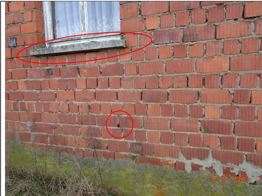
Foto 1: Das Mauerwerk der Scheune weist zahlreiche Ritzen auf, denen aufgrund der geringen Tiefe jedoch kein Potenzial als Fledermausquartiere zukommt. Unterhalb der Fensterbretter befinden sich waagerechte Spalten. Diese wurden mittels Endoskopkamera auf Besatz kontrolliert und nach festgestellter Absenz mittels Malervlies verstopft.
