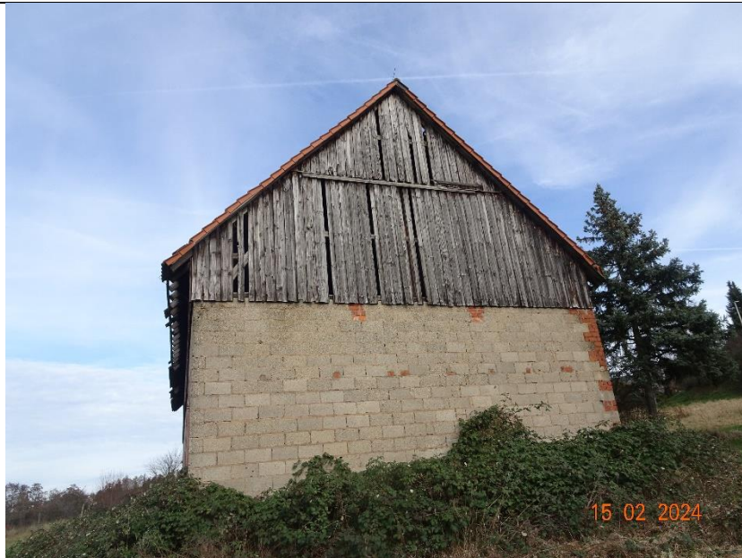
Foto 2: In der Holzfassade der südlichen Giebelseite fehlen einige Holzbretter, sodass die Fassade einige große Öffnungen aufweist und der Innenraum einfliegbar ist.
