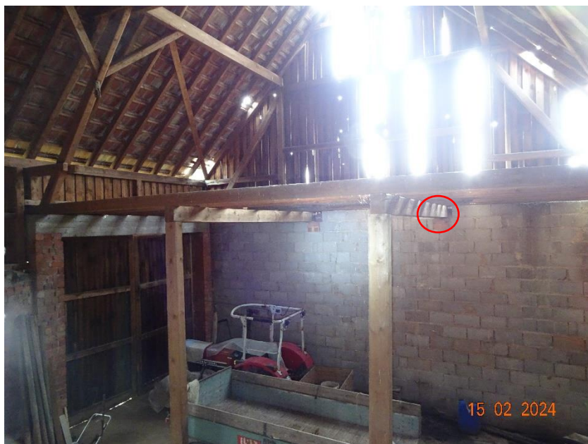
Foto 4: Blick nach Süden im Innenbereich der Scheune. In der markierten Nische wurde ein altes Nest vorgefunden (s. nächstes Bild).
