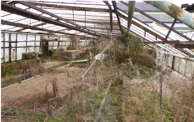
Bild 10: Das Innere eines der Treibhäuser der ehemaligen Gärtnerei. Wie am oberen Bildrand rechts zu sehen, sind die Glasscheiben von Dächern und Wänden z.T. nicht dicht.
