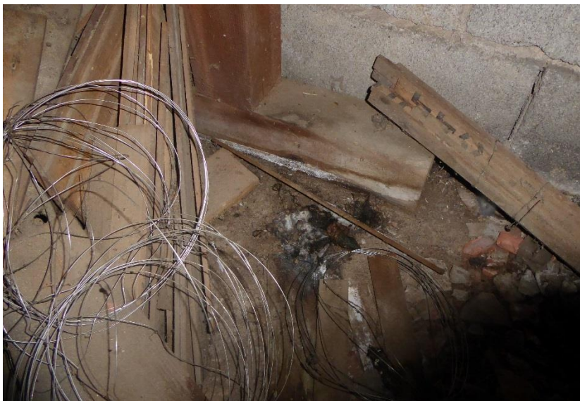
Foto 8: Unter dem Dach des ehemaligen Gärtnereigebäudes finden sich zahlreiche z.T. frische Marderkotspuren, die ein Quartier des Steinmarders in diesem Bereich vermuten lassen.
